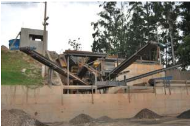
Figura 4. Vista geral do britador de mandíbulas com esteiras transportadoras dos resíduos
